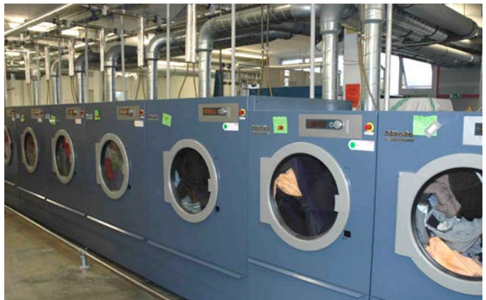
Trocknerreihe bei der Kopp Textilpflege. Mit den Maschinen werden täglich drei Tonnen Bewohnerwäsche getrocknet.
